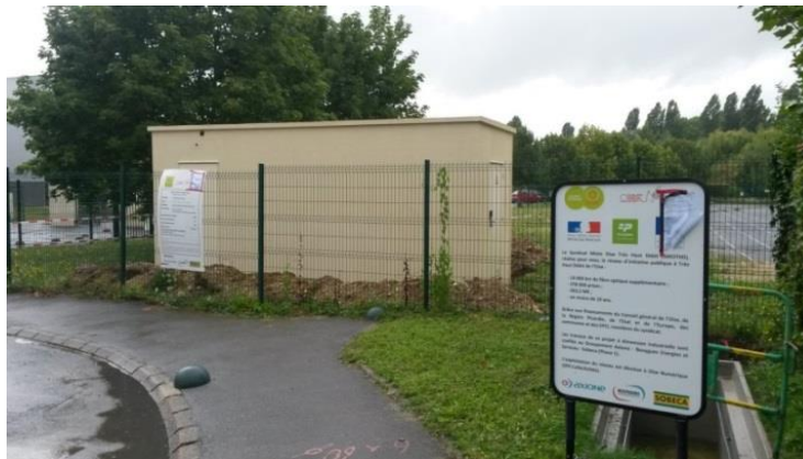
Nœud de raccordement optique
